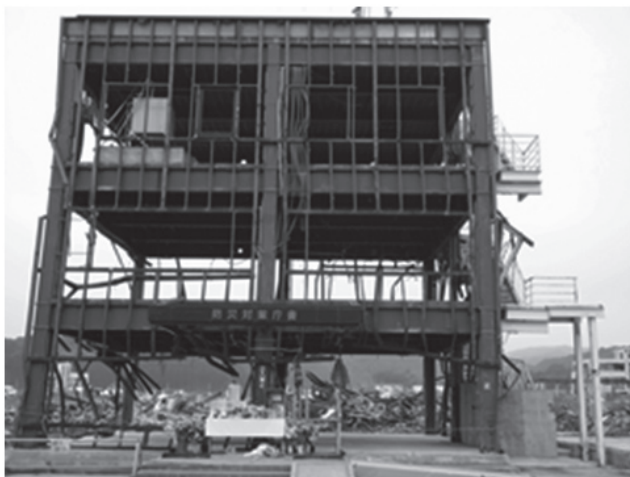
図表 2 津波で大破した岩手県南三陸町の防災庁舎（撮影：永田）
