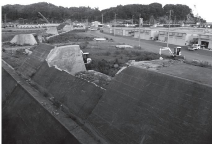
図表7 津波で大破した岩手県宮古市田老堤防（撮影：永田）
