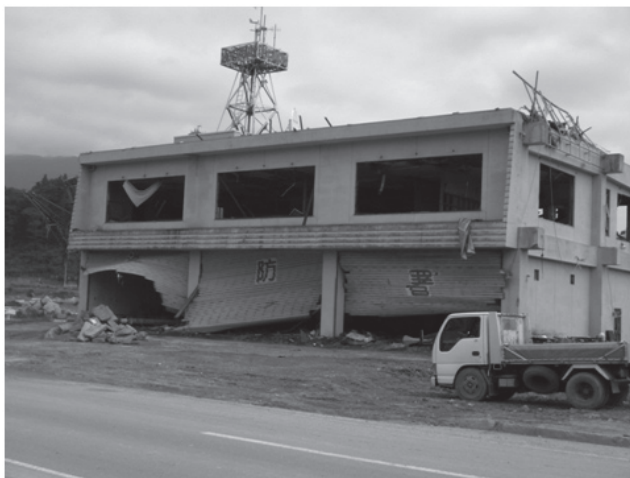
図表 1 津波で大破した陸前高田市の消防署（撮影：永田）
